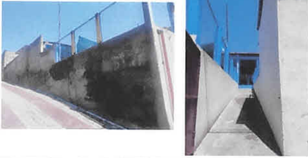
Foto1: Reparacion de muro perimetral, area de patio 1 y 2 en colocacion de cernido con sabieta y cambio de malla
